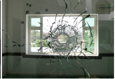
واحدة من مئات الثقوب التي تسببت رصاصات تم إطلاقها على مبنى وزارة المياه والبيئة في منطقة الحصبة - صنعاء
